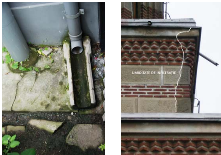
Fig. 1. Sistem defectuos de scurgere a apelor pluviale care favorizează apariția agenților biodeteriogeni și umiditatea de infiltrație
