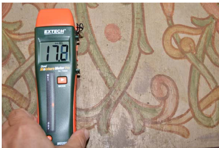
Fig. 5. Determinarea umidității relative a zidăriei folosind un umidometru portabil cu o tehnologie electro-magnetică nedistructivă
