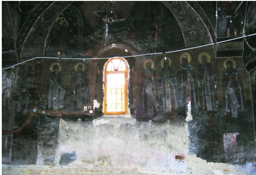
Fig. 4. Dezagregarea tencuielilor datorate umidității de capilaritate
